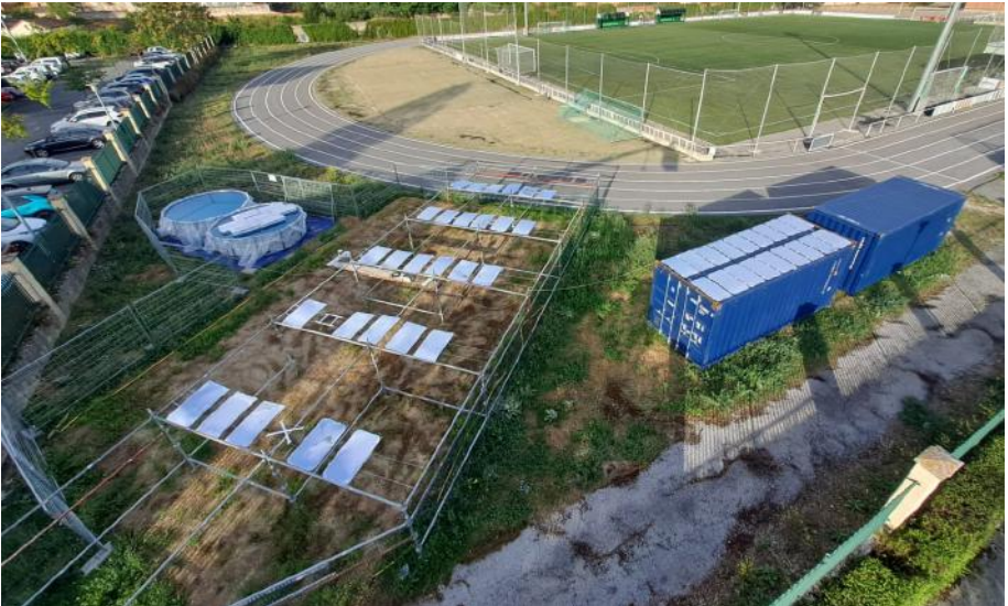
Vista general de la instalación en el polideportivo de Villava | Atarrabia.
